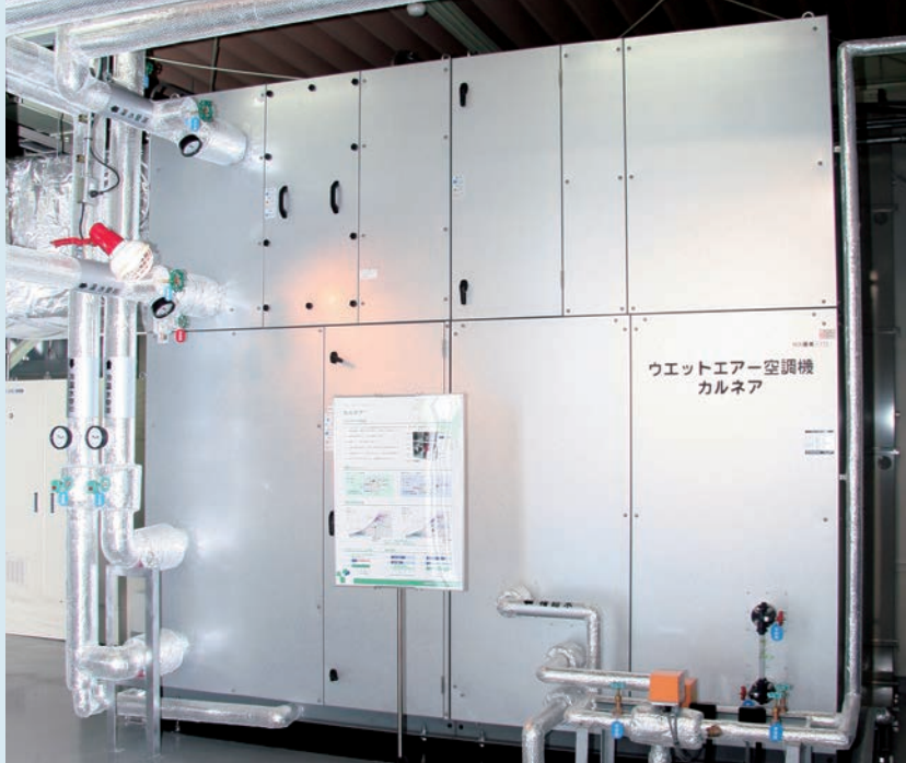
CAB-ZONEの核となるウエットエア空調機「カルネア」▲
